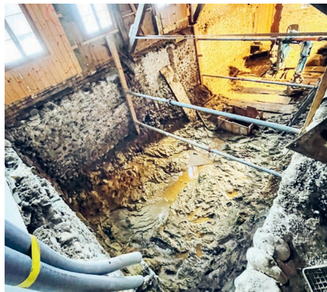
▲ Wasser im Keller während Bauarbeiten
